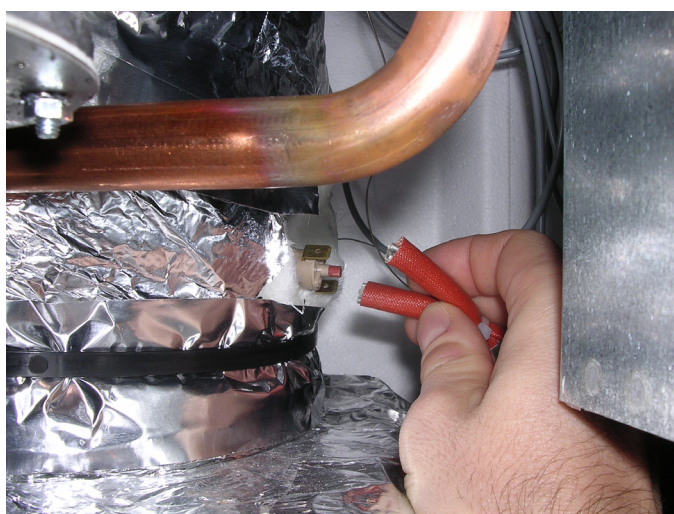
Figure 2 – Inspection du thermostat de sécurité du générateur
